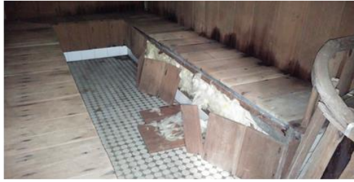
Saunas com forração em madeira apresentando descolamento e empenamento dos painéis
