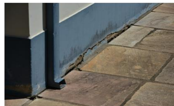
Vestiários e banheiros em péssimo estado de conservação
