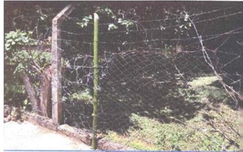
Telas danificadas, permitindo acesso irregular e prejudicando a segurança
