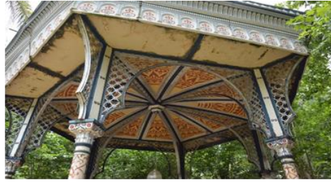
Fontanários em estado de conservação inadequado, com tetos danificados e descolamentos visíveis
