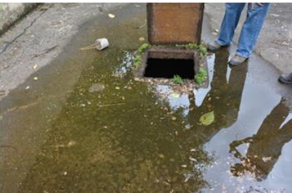
Pista de cooper com pontos de erosão, apresentando riscos aos usuários
