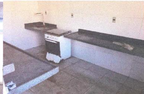
Lavanderia e refeitório do balneário desativados e em péssimo estado de conservação
