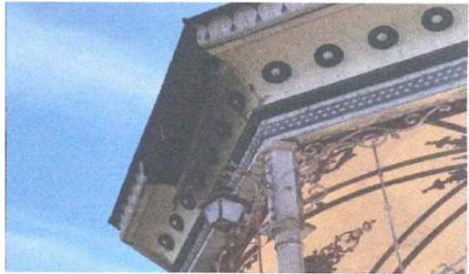
Coreto com danos estruturais acentuados
