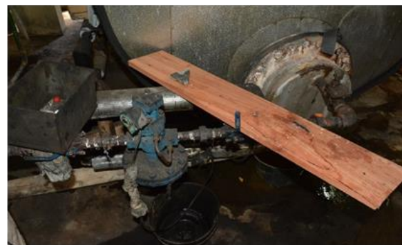
Caldeira operando sem confiabilidade e segurança, funcionando precariamente
