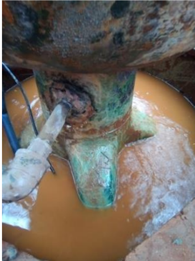
Foto 3. Sapatas de fixação do bulbo na tubulação do poço. O tubo que sai da base do bulbo é utilizado para fazer a descarga da água, o que deflagra o jorro do gêiser. Observar o estado da junção do tubo com o bulbo, evidenciando marcas de vazamento intermitente.
