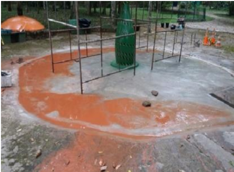
Foto 5. Água com abundante argila avermelhada, cuja fonte mais provável é o carreamento do material usado no enchimento da escavação pelos vazamentos.
